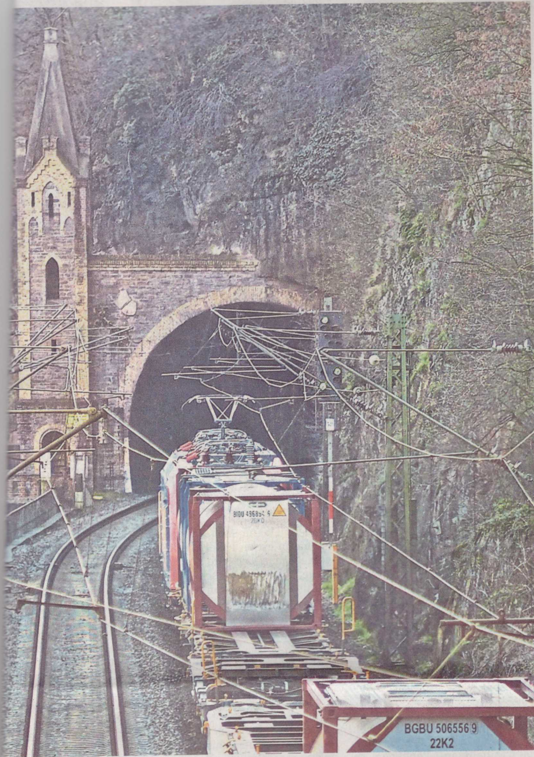
ngen der Felsformation, feine Risse im Gestein am Kammerecktunnel und mögliche Korrosionsschäden an Stahlelementen des Tunnelgewölbes machen der BI „Oberwesel 22“ Sorgen. Foto: Thomas Torkler
